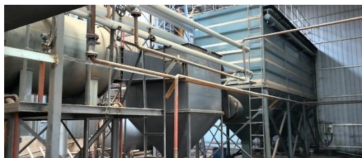
DA001（陶瓷多管旋风除尘+袋式除尘）
