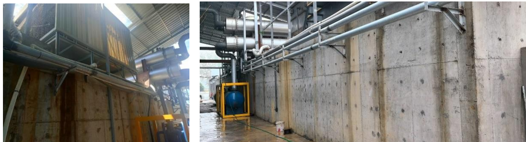
综合废水处理设施
