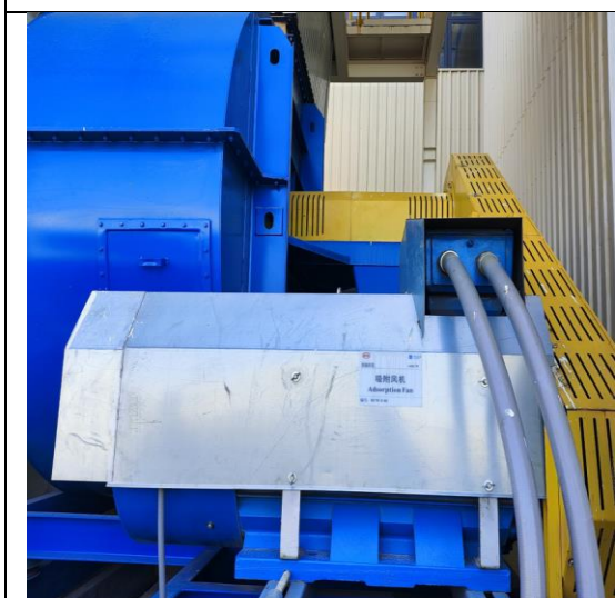
6#工厂喷漆废气吸附风机
