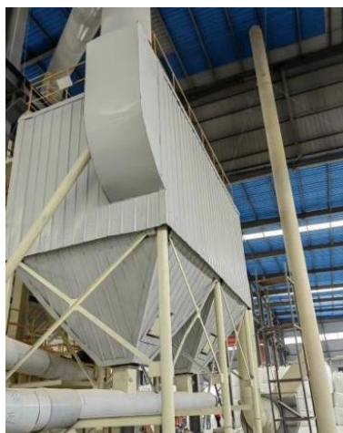
三号生产线废气布袋除尘器
