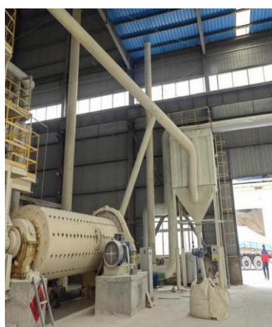
粉磨、均化废气布袋除尘器
