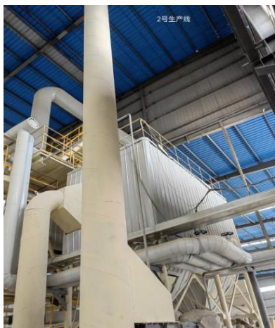
二号生产线废气布袋除尘器
