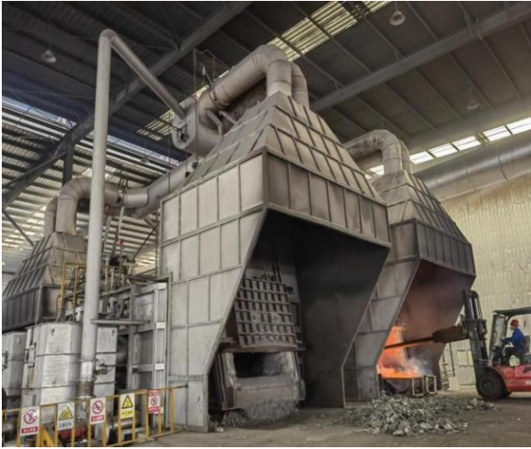
熔炼炉及其废气收集管道（架空）
