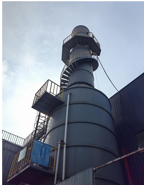
DA001 排气筒+采样平台
