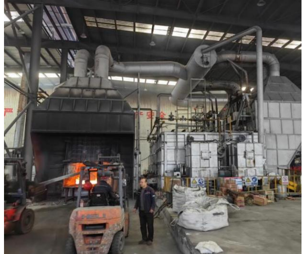
精炼炉及其废气收集管道（架空）
