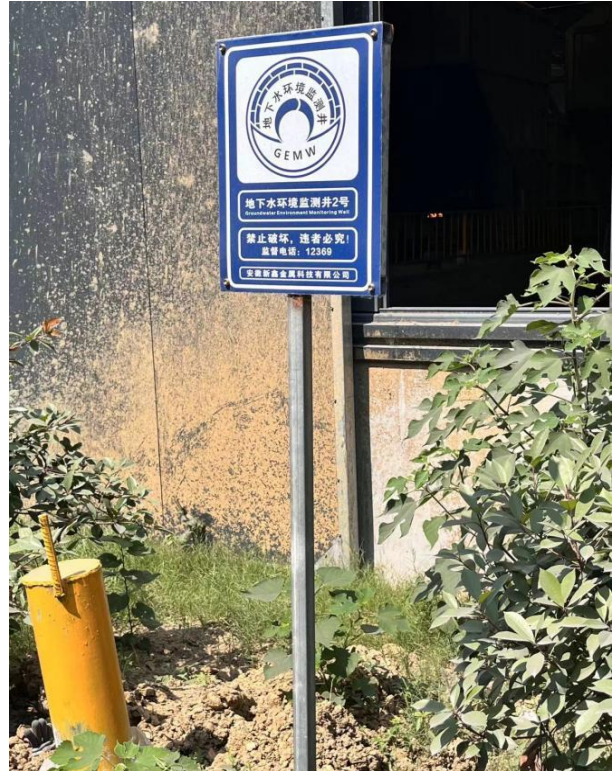
2#地下水监测井
