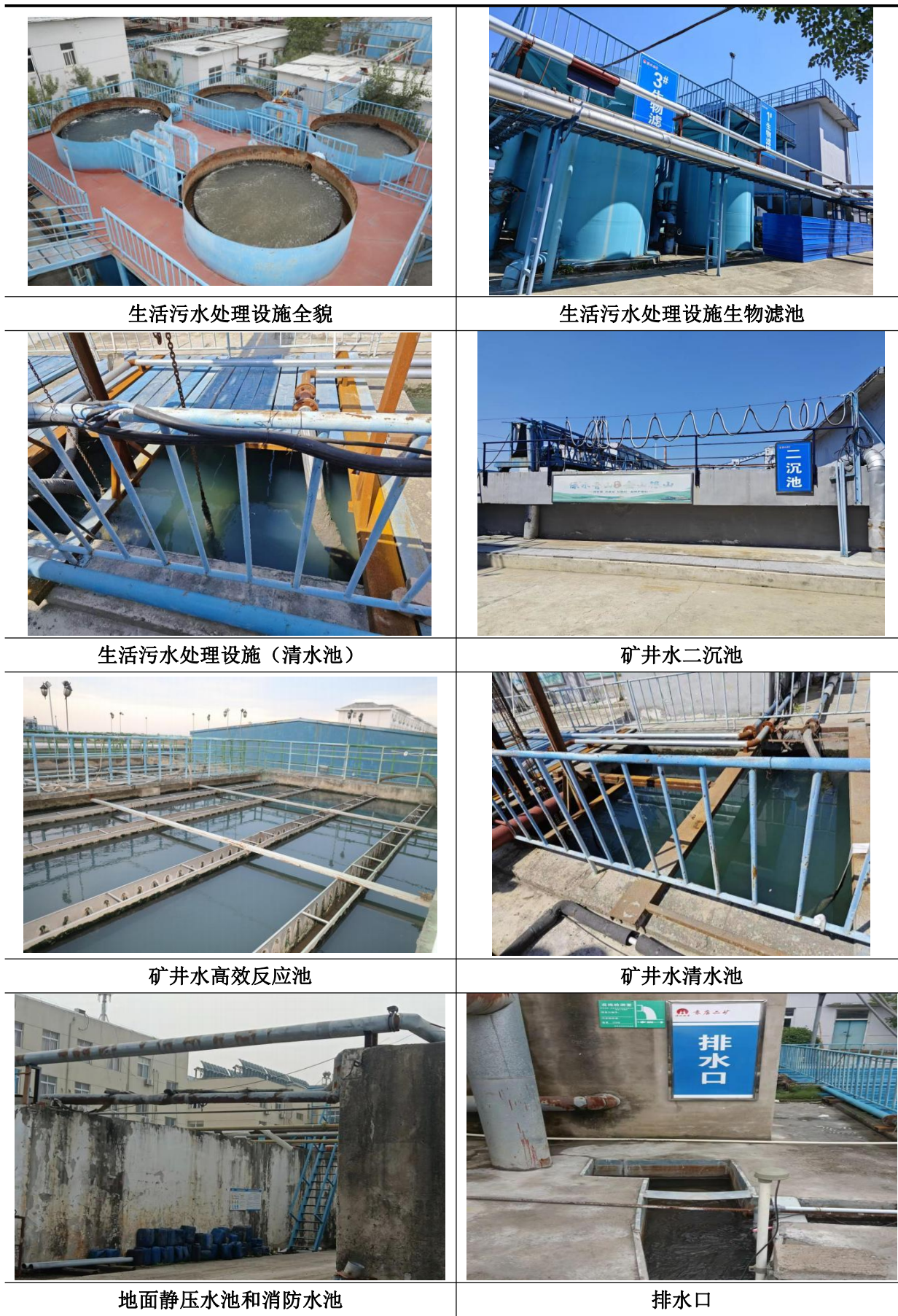
图 8.3-3 污水处理站处理设施照片
