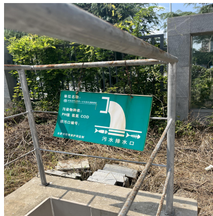
废水排放口标识牌
