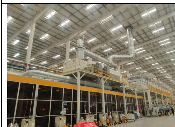
2#厂房 (焊装车间) 焊接废气密闭收集
