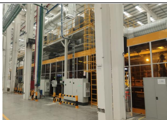
2#厂房 (焊装车间) 焊接废气密闭收集
